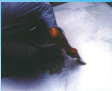
受水槽内の補修施工例 受水槽・排水槽等の全面ライニング、部分補修、止水補修ができます。
