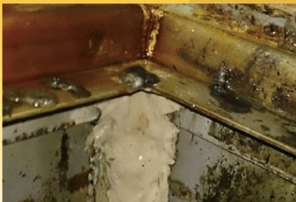
排水マス内の補修例
